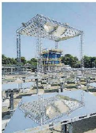
Polo energetico. Il primo investimento realizzato da A2A alla Centrale di Archi
